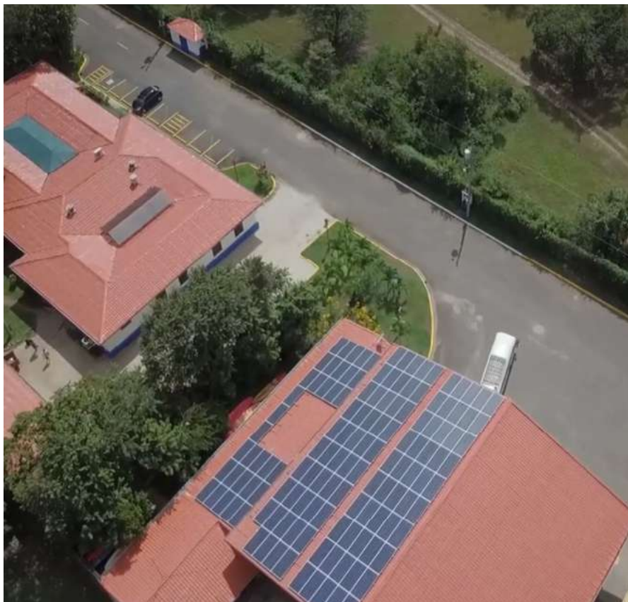
Paneles instalados Sede Swiss Travel Guanacaste
